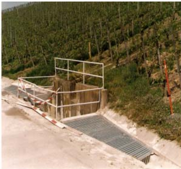
Abb. 3: Schlammfang (1) . Nach dem Um- bzw. Einbau der Ausstiegshilfe. Foto: HANNELORE HELLWIG.
