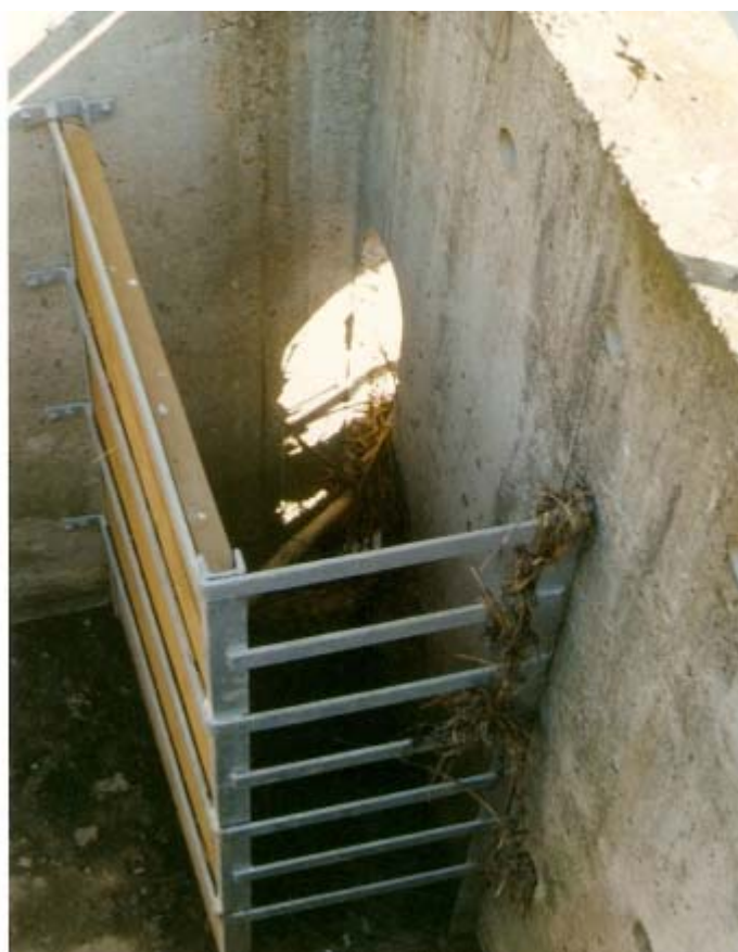
Abb. 7: Schlammfang (3) . Nach dem Um- bzw. Einbau der Ausstiegshilfe. Foto: HANNELORE HELLWIG.
